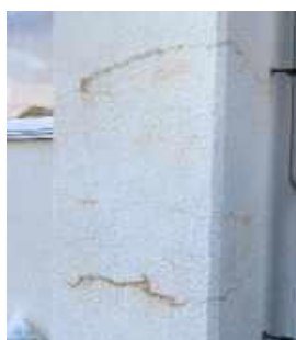
錆汁を伴うひび割れ
