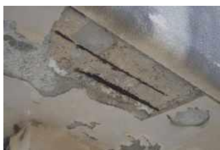
コンクリートの剥落
