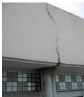
構造躯体のひび割れ
