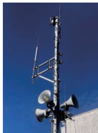
▲小美玉市役所の防災無線アンテナ
