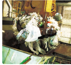
処理設備：供給クレーン
